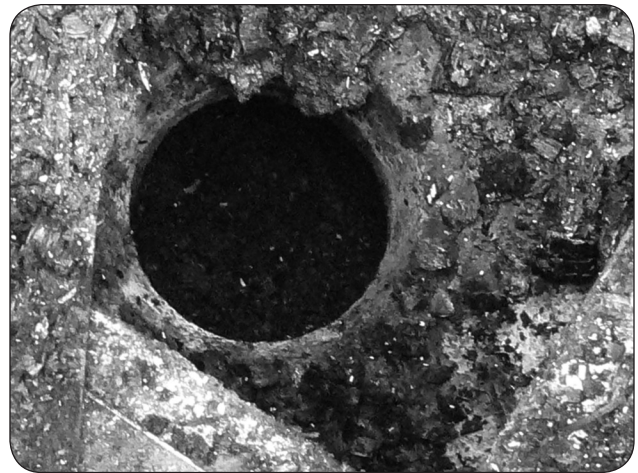
Figure 2. Cet orifice de vidange gravitaire ouvert donnant sur une fosse inférieure serait la source de méthane à l'origine d'un incendie dans la pouponnière d'un élevage porcin.
