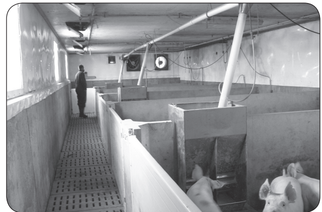
Figure 1. Tous les locaux situés au-dessus des structures de stockage de lisier doivent être ventilés en permanence.
